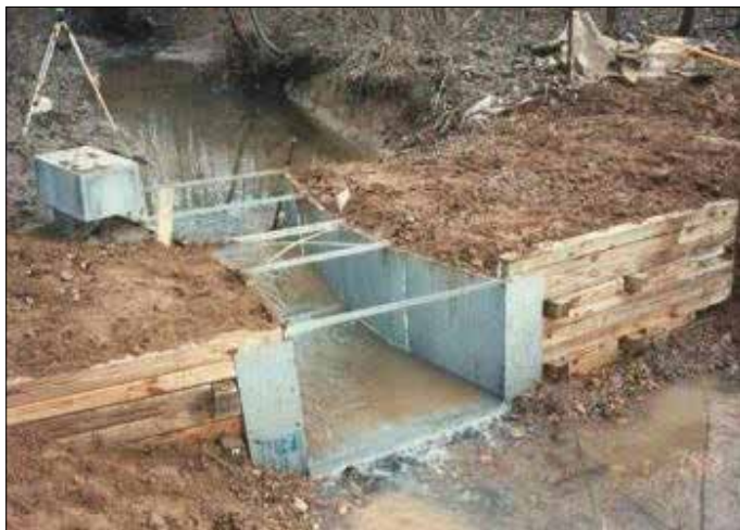
شکل ۷-۶۳. فلوم فلزی ایجاد شده در مسیر یک نهر آب
